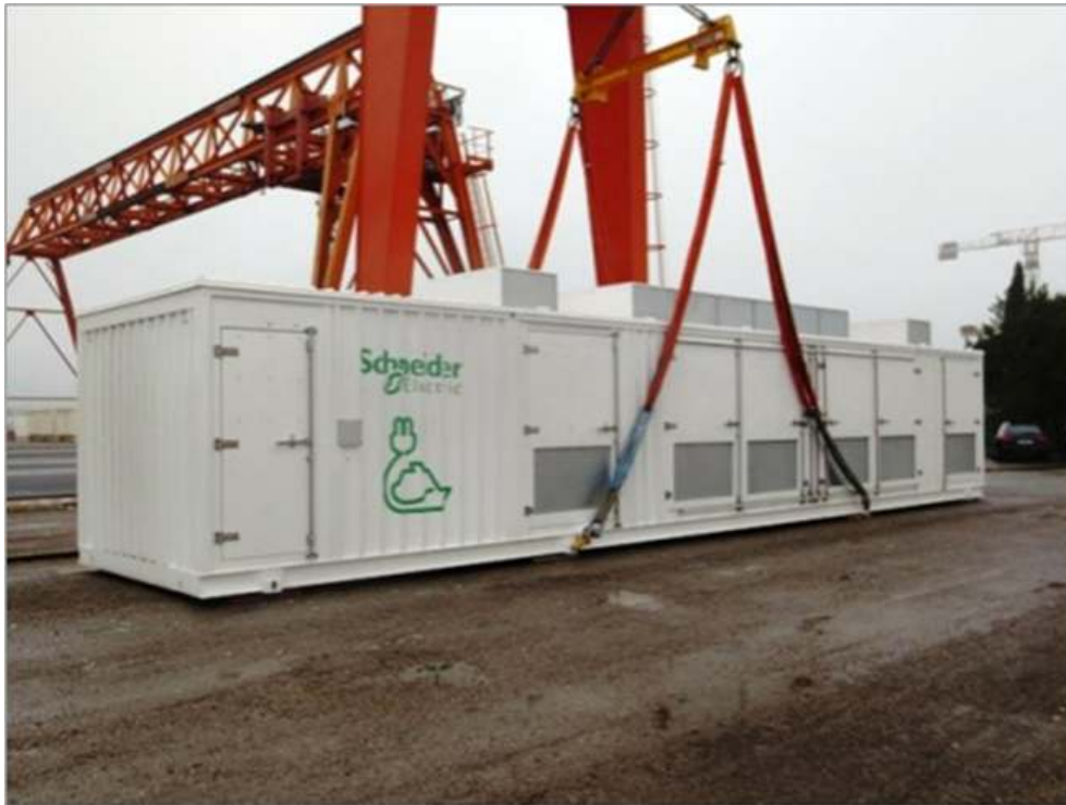
Figura 8. Sistema Modular (ShoreBox) On Shore Power Supply instalado en Bergen, Noruega
